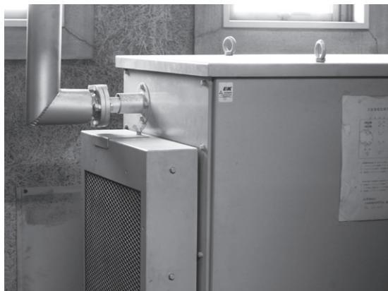
役場庁舎の非常用発電機
