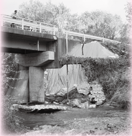
被災した松山橋
